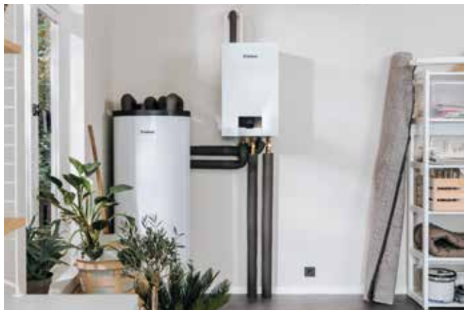
Stație hidraulică combinată cu un boiler de 250 litri
